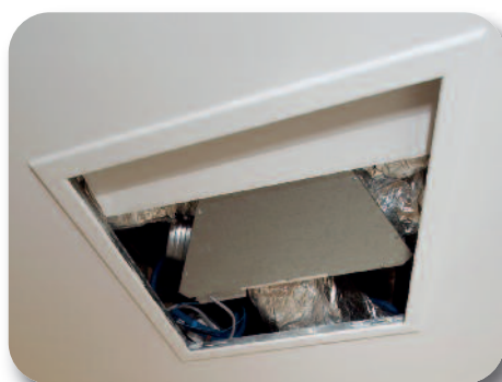
Trappe d'accès au module de chauffage.
