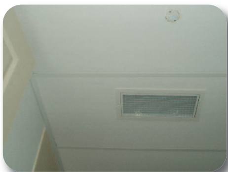
Grille de recyclage - En faux-plafond.
