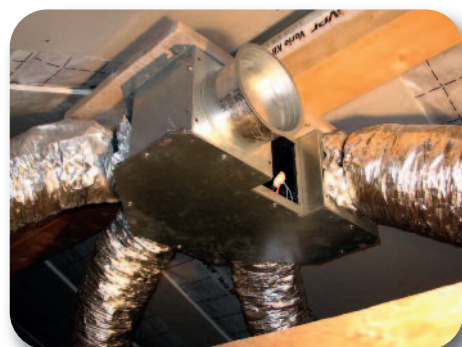
Module de chauffage - En faux-plafond.
