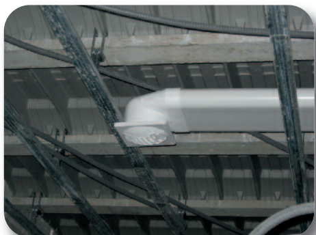
Réseau Minigaine - En faux-plafond.
