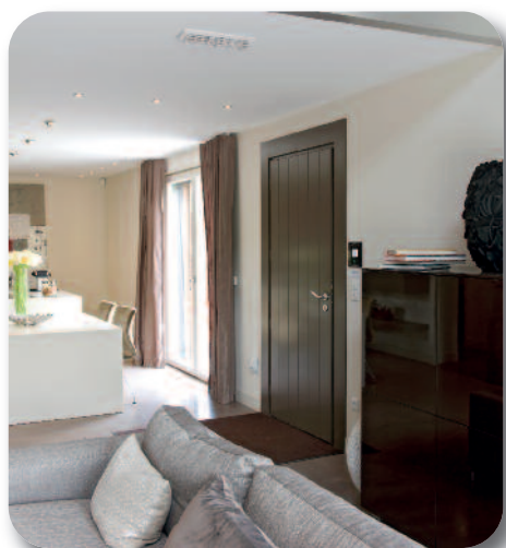
Bouche d'insufflation - Salon.
