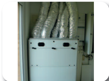
Centrale - Local technique.
