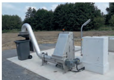
Station de pompage équipée d'un dégrilleur automatique
