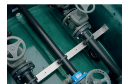
Intérieur du regard avec clapets et vannes
