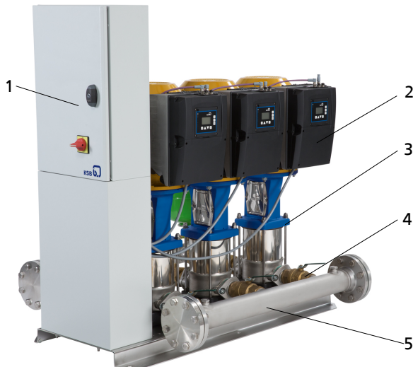
III. 1: Vue d'ensemble surpresseur
