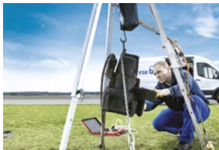
Maintenance d'une station de relevage équipée d'une pompe Amarex KRT
