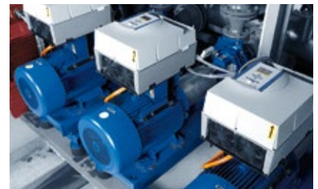
Chaque pompe a un débit d'alimentation de 100m³/h
