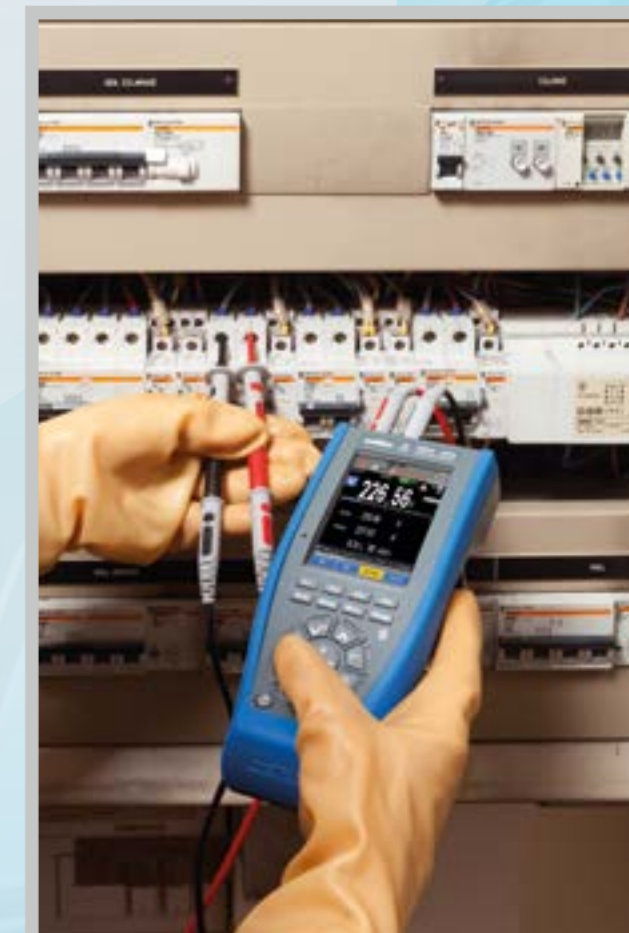
Mesures sur armoires électriques
