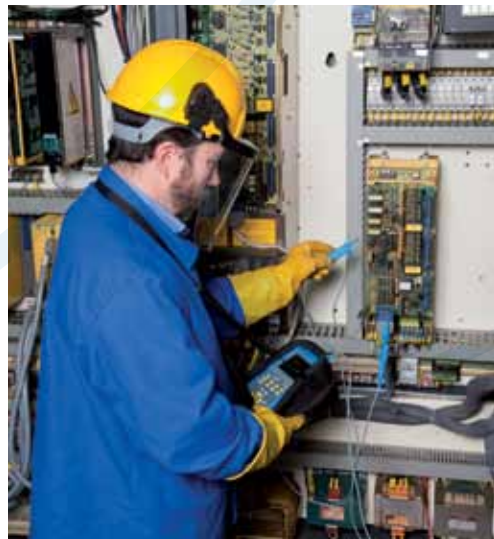
Sur la partie contrôle commande électronique d'une machine-outil, vérification du bon fonctionnement.
