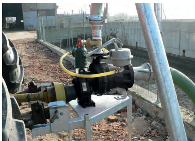
Exemple d'installation lisier sur une distance de 500 m
