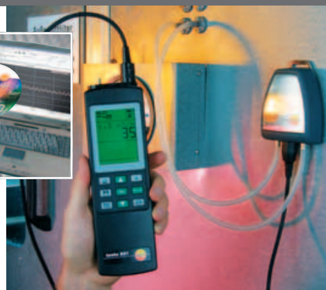
Contrôles de filtres avec sonde externe 100 Pa
