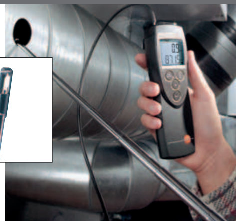
Contrôle de la vitesse d'air en gaine de climatisation
