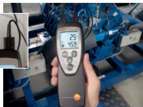
Contrôle de température différentielle à l'aide de sonde pour tuyauterie sur un compresseur
